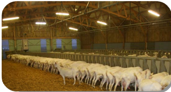
Installation photopériodique avec des lampes fluorescentes
